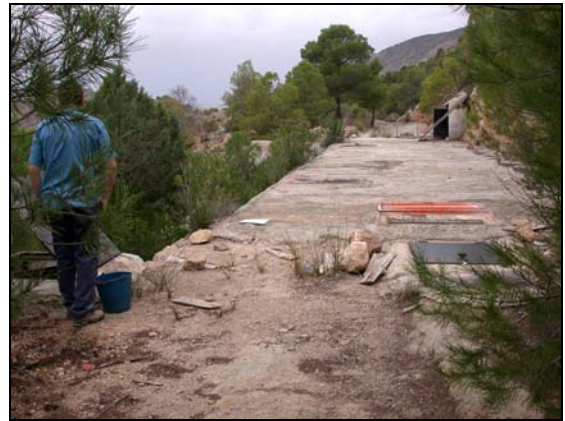
Arqueta donde comienza la tubería
