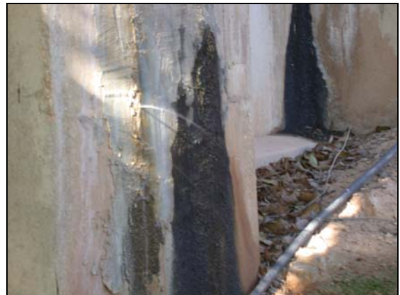
Fisuras en el Depósito Alto Castillo
